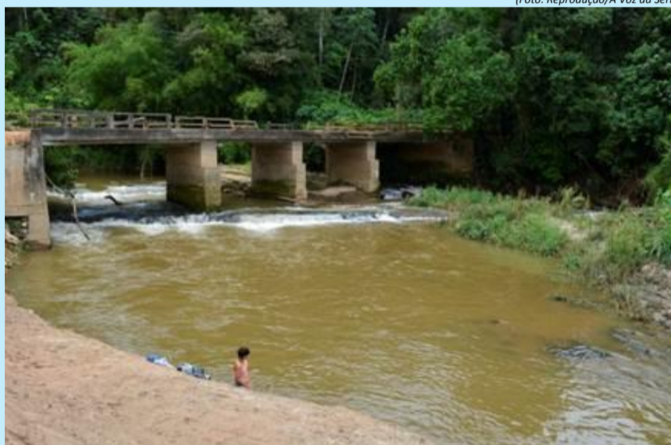
Local onde antes ficava cheio de banhistas, hoje é considerado de risco
